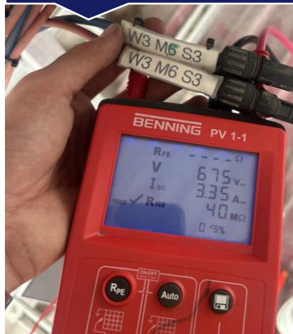
Fehlersuche auf der Anlage
